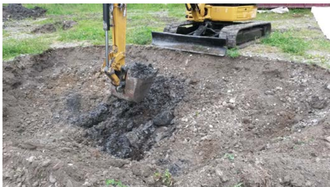
Vue des matériaux pollués
