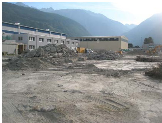
Vue du chantier : séparation des blocs de béton
