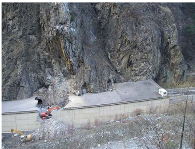
Etat de la galerie après l'éboulement du 29.11.2003
