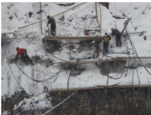
Pose de clous passifs sur le portail du tunnel d'accès à Châtelard, au-dessus de l'Eau Noire
