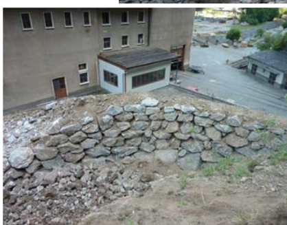
Blocs éboulés le 12.11.2010 dans le canal de Salanfe et digue pare-pierres construite en juillet 2011.
