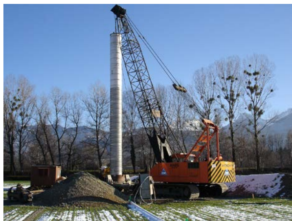
Puits SI06 pour l'alimentation en eau potable de la ville de Monthey, sur le territoire communal de Massongex
